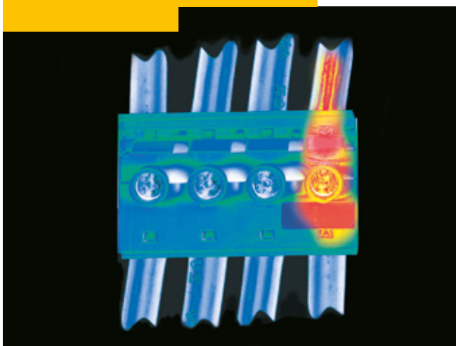
Überlastung des Neutralleiters
